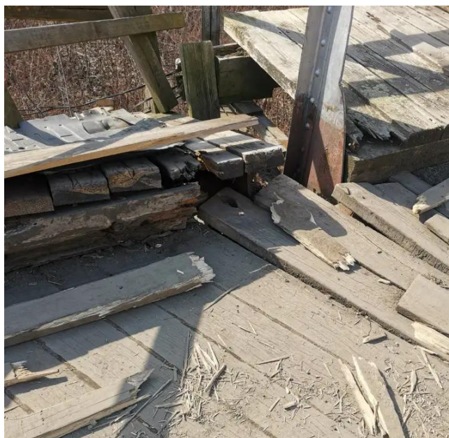
Figura 41. Probleme structurale la nivelul podul rutier peste r. Tisa ce asigură legătura între România și Ucraina
